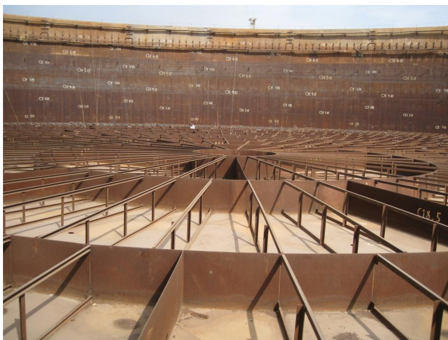
شکل ۱۱-۰ سقف شناور شامل جداکننده ها و سلول ها (خن)
