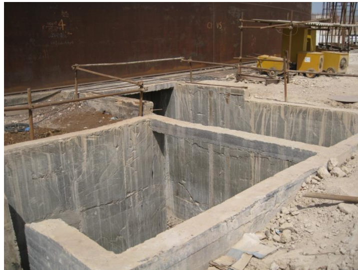
شکل ۴-۰: حوضچه های ورودی و خروجی لوله ها به مخازن
